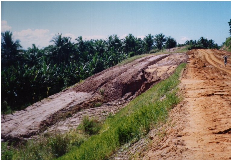
Figura 1: Panorâmica do bota-fora com erosões (fase de implantação).
