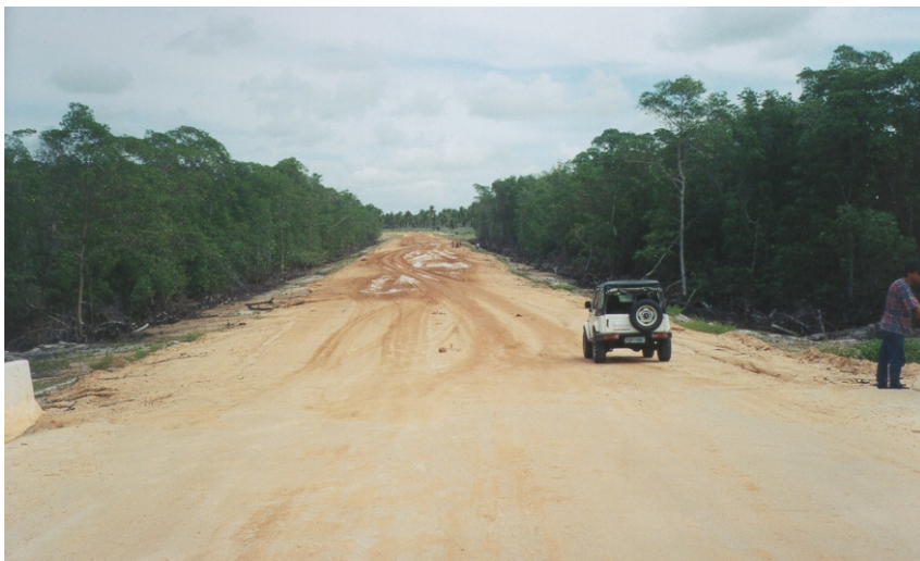
Figura 3: Trecho implantado sobre área de manguezal.
